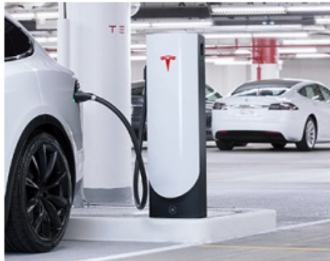
Ladesäule für einen Tesla. Die Gusspläne des E-Autopioniers könnten das Thema großflächiger Strukturguss in der
